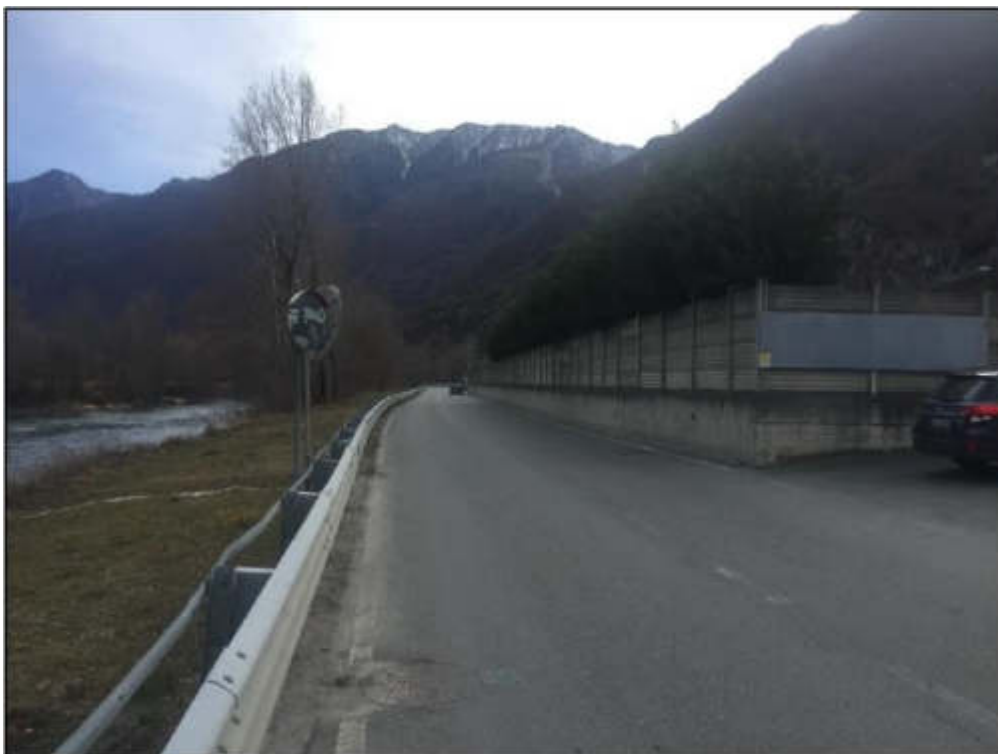
Particolare del muro di contenimento in ca e recinzione continua in cls Confine orientale
