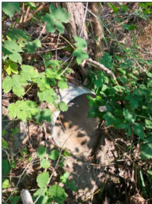
Tubazione di scarico
